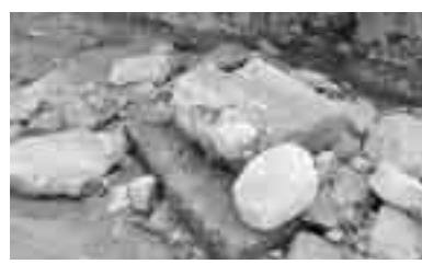
POZZETTO TAPPATO CON UN BLOCCO DI CEMENTO
